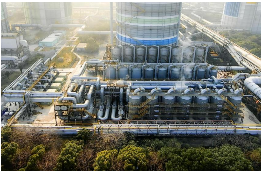
图 2 宝山基地焦炉煤气精脱硫装置
